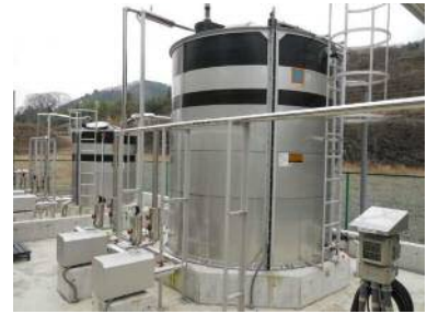
写真-1 凝集剤添加設備 (手前 PAC, 奥アルカリ剤)
